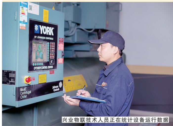
兴业物联技术人员正在统计设备运行数据
