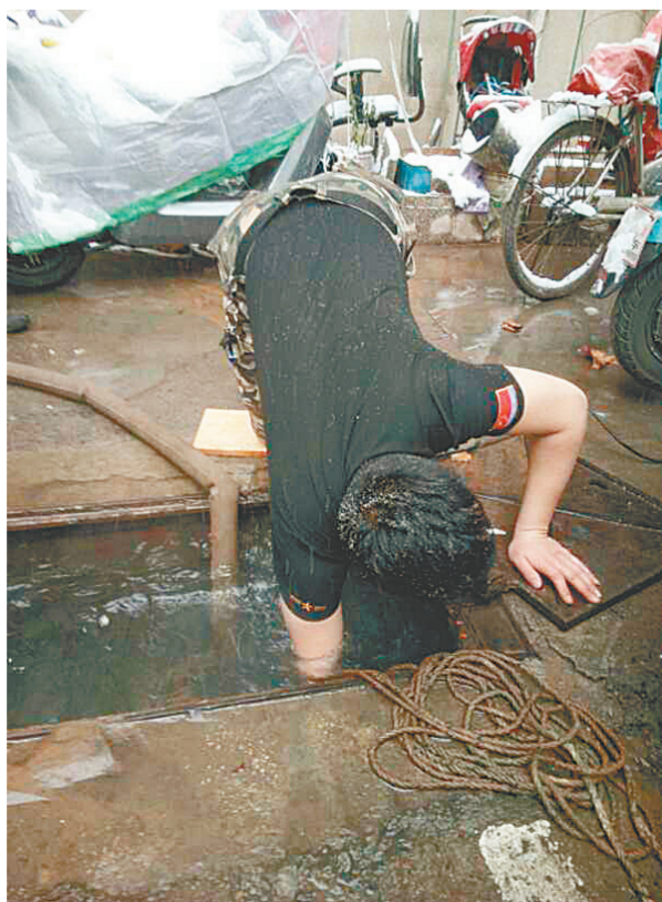
昨天,天寒地冻,但在郑州一漏水管抢修点,却上演了感人一幕。早上7点多,丰乐路17号院的一处表井内,因井盖砸断水管,造成突发漏水。郑州自来水公司营业处水维修班张威赶到现场,紧急处置。因水势较大,抽水不及,同时为了对周边市民用水不产生影响,张威毫不犹豫撩掉衣服,探水抢修。(郑州自来水公司供图)
