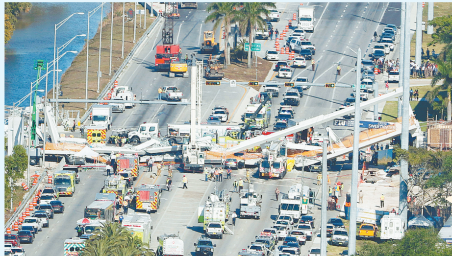
美国佛罗里达州迈阿密市一座在建街天桥15日突然坍塌，确认致死至少6人，多人受伤。
