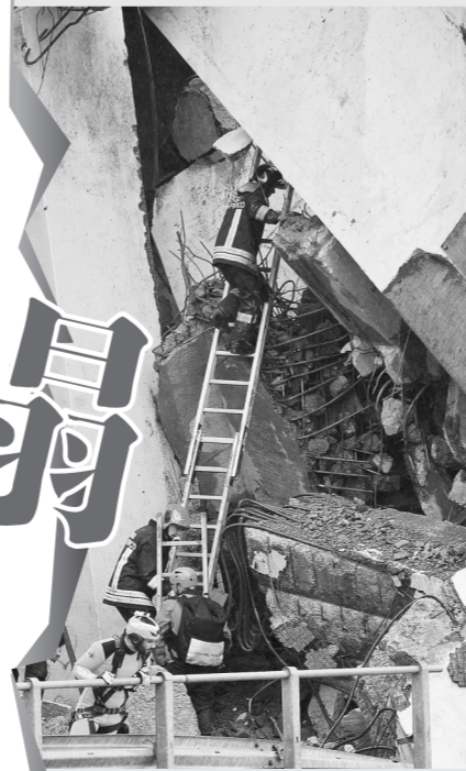
救援人员在垮塌的公路桥废墟上工作。
