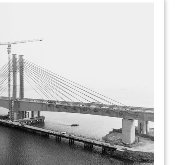
位于湖北省襄阳市境内的蒙华铁路汉江特大桥(10月18日无人机拍摄)。10月18日,蒙华铁路重点控制性工程汉江特大桥主桥顺利合龙。蒙华铁路北起内蒙古鄂尔多斯,南至江西吉安,是我国在建的最长重载铁路。
