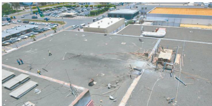
这是6月13日在沙特西南部阿西尔省艾卜哈市拍摄的遭袭机场建筑。
