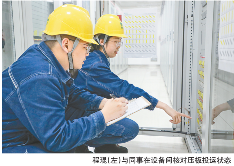
程琨(左)与同事在设备间核对压板投运状态
