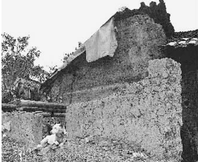
上图:云南省盐津县豆沙镇长胜村农民李孝元在介绍自己的新居;下图:在地震中被损坏的李孝元的土坯房。2006年7月22日、8月25日,云南盐津县、大关县境内相继发生两次5级以上地震,大批房屋和基础设施受到不同程度损坏,大批群众受灾。灾后,云南省、昭通市和地震受灾县等各级政府先后派出190多个帮扶小组赶赴救灾点,与各族群众和武警官兵一起抢险排危、重建家园、安置灾民。目前,灾区已基本恢复正常生活秩序。春节前,7000多户群众有望搬入新居。 新华社发
