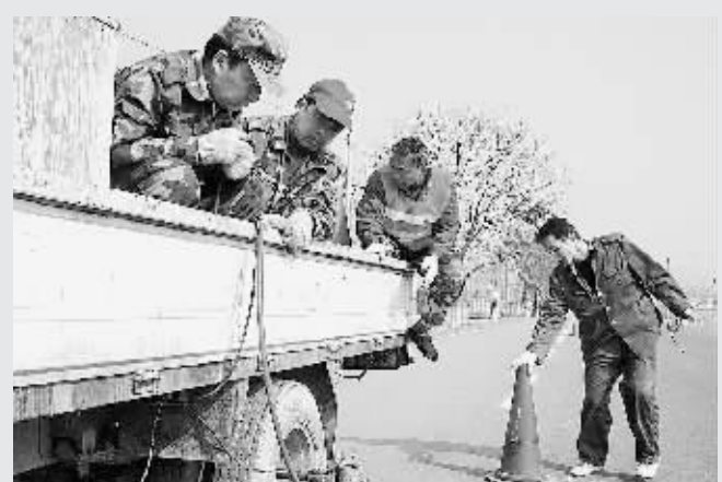
为改善道路行车环境,提高人们安全意识,遏制交通事故多发势头,惠济区交通局自筹资金30多万元,从昨日起,对辖区内清华园路等通向各社区的200多公里道路进行标线安装工作。本报记者 王影 摄
