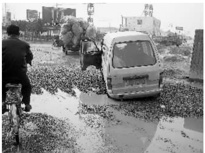
南三环与大学路交叉口正在施工,由于对道路维护不够,造成施工工地外面道路破损严重,经常有车辆在这里被道路卡住。本报记者 靳刚 摄
