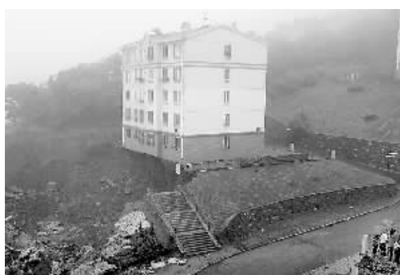
6月28日拍摄的地基塌陷的居民楼。当日凌晨,大连市沙河口区锦霞南园一处山体发生塌方滑坡,造成坡上的10号居民楼地基大面积塌陷,楼体的一部分已悬空。新华社发
