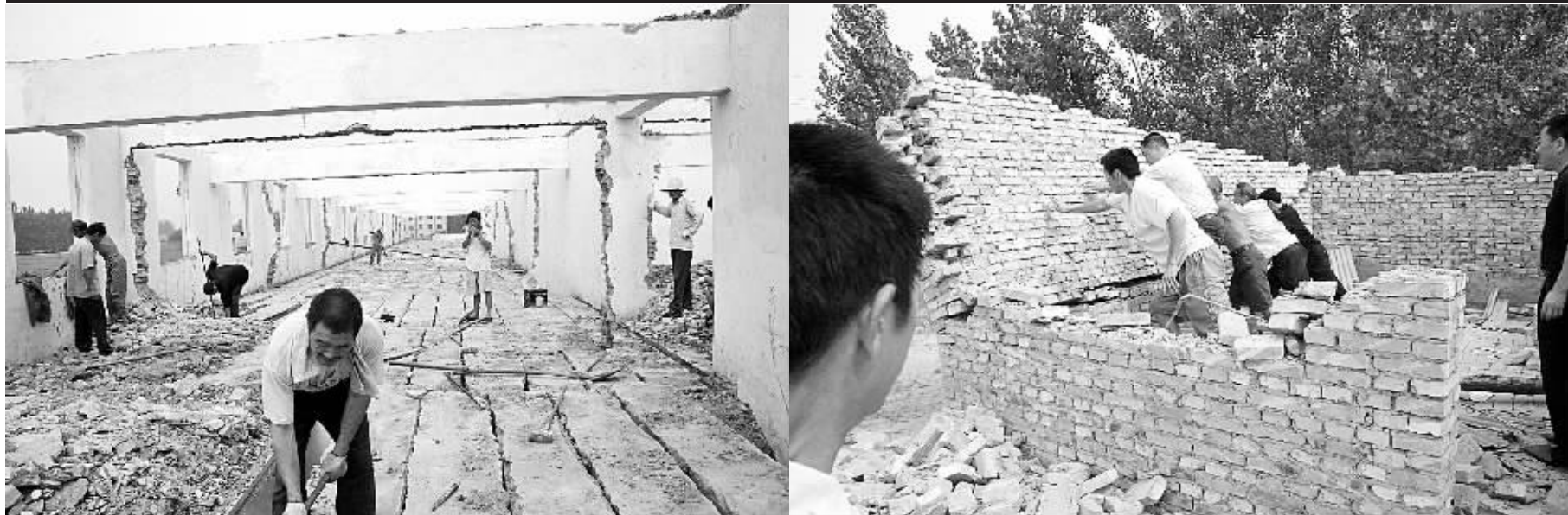
施工人员正在拆除位于惠济区花园口镇的一处小产权房项目
