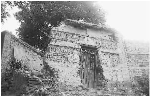
已经倒塌的老房子，只剩下半壁墙面。
