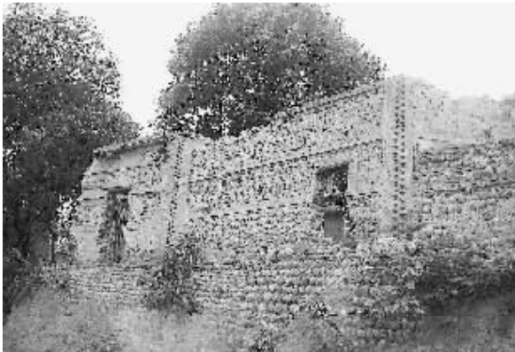
已经倒塌的老房子，只剩下半壁墙面。
