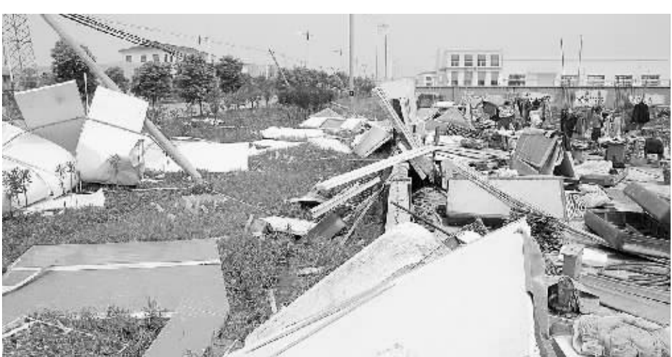
右下图 25日19时45分,苏州市相城区北桥镇一建筑工地遭受龙卷风袭击,造成3人受伤,20多间工地简易房屋被毁。
