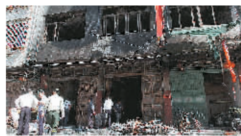
10月22日,福建省莆田市秀屿区笏石镇飞达鞋面加工坊21日晚发生的特别重大火灾事故已造成37人死亡,19人受伤。目前,福建省和莆田市正在积极开展抢救伤员、安抚死者家属和其他各项善后工作。图为工作人员在莆田特大火灾现场勘查。 新华社发
