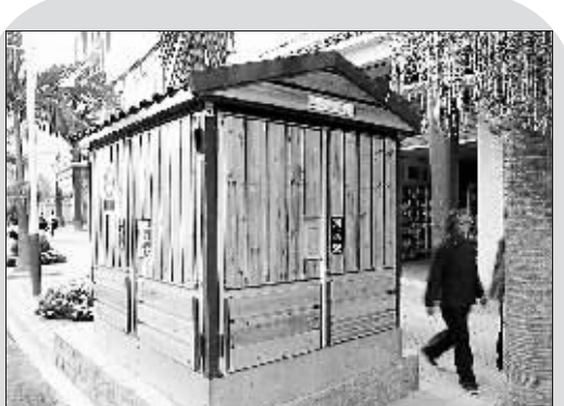
近日,贵州省荔波县街头出现一种既安全又美观实用的新型变压器室。这种一体式变压器室设计新颖,既保障行人安全,又美观实用。
