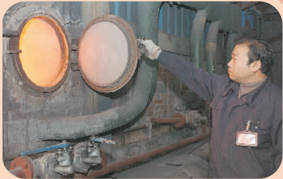
图为郑州市热力总公司枣庄供热分公司工作人员在点火后查看炉膛温度和燃煤燃烧情况。本报记者 汪静文 摄
