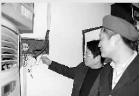
昨日上午,针对市场商户中出现的私拉电线、私改线路的情况,河南科技市场管委会派出工作人员进行排查,以防止因违规改造电路引发火灾事故。高凯 雷芳芳 摄
