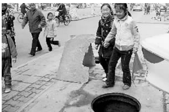
昨日,在伏牛路与颍河路交叉口南侧伏牛路二小等几所中小学附近,两个窨井大张口,给过往行人,尤其是中小学生在留下了安全隐患。 刘玉娟 王凤生 摄
