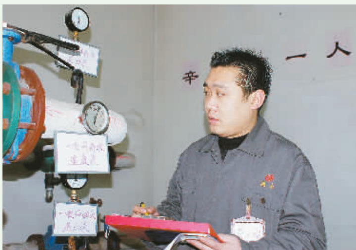
图为工作人员正在记录供水温度。
