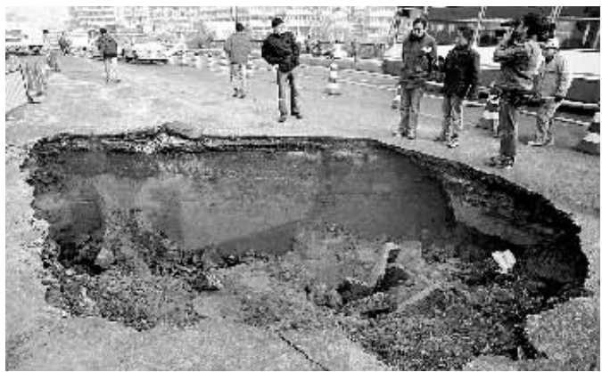
1月7日,杭州艮山运河桥机动车道桥面坍塌,形成一个直径约5米、深约2米的大坑,无人伤亡。
