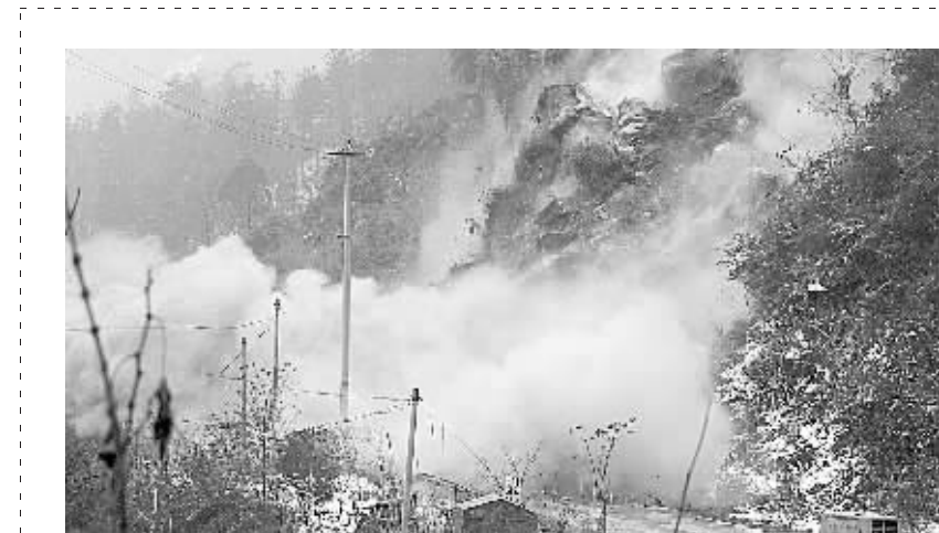
1月23日,已与山体发生裂缝随时有崩塌危险的巨型岩石被定向爆破。为根除隐患,湖北宜都市有关部门1月23日对省主干公路鸡来线聂家河段尖峰垭山脚下的一块巨型岩石滑体进行定向爆破。而后,施工队伍24小时对爆破的碎石进行清理。预计3天时间可将碎石全部清理完毕。新华社发
