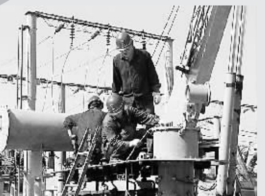
为了让新密市民收听收看全国“两会”盛况,新密市电业局对所辖18个变电站的电力设备进行预试及检修,及时发现和消除运行中的设备隐患。 本报记者 刘俊礼 通讯员 刘辉 摄
