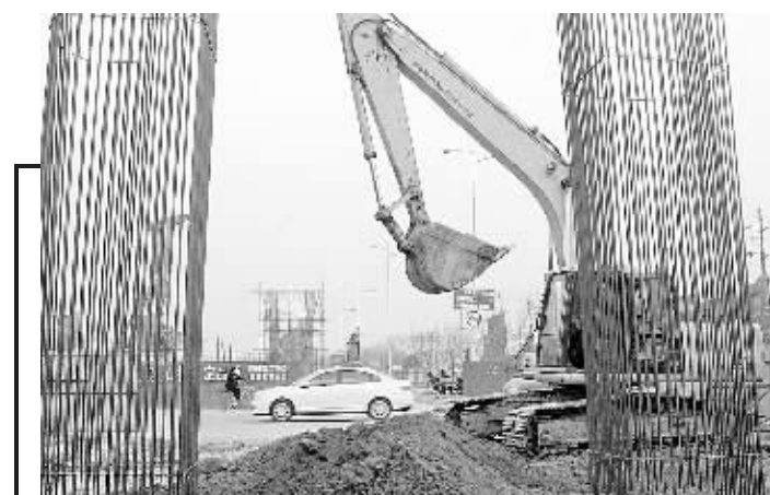
我市重点工程之一的南三环大学路立交桥建设工程经过建设单位的日夜奋战,目前桩基施工已接近尾声,桥梁承台和墩柱正在加紧施工。据承建施工任务的市政二公司介绍,该桥全长865米,预计今年下半年可实现通车。
