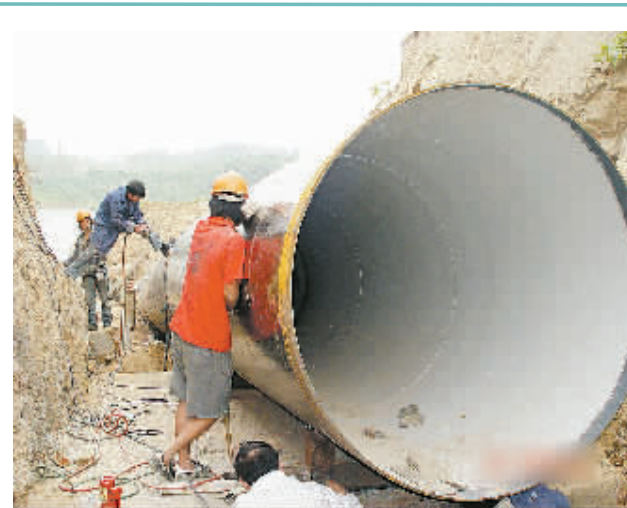
目前柿园输水管道仅有一条输水干管通往柿园水厂,如果再敷设一条备用输水管道,郑州城市供水系统的安全性可大大提高。图为柿园输水管道爆管抢修现场。
