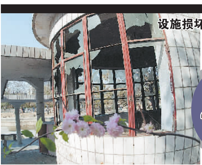
设施损坏 水质发臭 本报(记者 梁月琳 唐强 实习生 段敏敏 文/图)位于郑州大学老校区南北校区之间的眉湖曾经是郑州一景,但现在却是一片脏乱差,环境设施遭到破坏,湖水腐败变质呈黄绿色,散发着腥臭气息。昨日,市民向本报反映了上述情况。 记者在现场看到,一汪黄绿色湖水勉强能遮盖住湖底,水面上漂浮着各种垃圾。湖心一架很美的石桥,桥两边的石栏杆、石凳子几乎全被推入湖中,桥头堆起了一大堆黄土。与石桥相连的一座亭子,周边的玻璃全部被打
