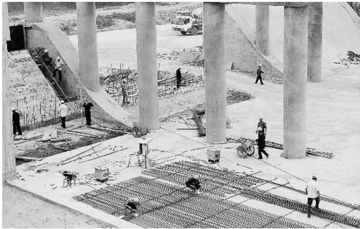
昨日,记者在新郑市轩辕水库建设工地看到,土方开挖、桥梁灌注桩、溢流坝等项目已基本完成。该工程是一座以防洪、灌溉、交通、景观为一体的重点工程,总投资1608万元,预计8月底完工。
