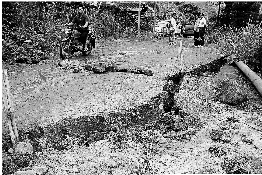
20日在广西贺州市平桂管理区拍摄的一段坍塌的道路。受持续强降雨影响,广西贺州市平桂管理区发生多处山体滑坡地质灾害,部分道路交通中断,大批民房受损。新华社发
