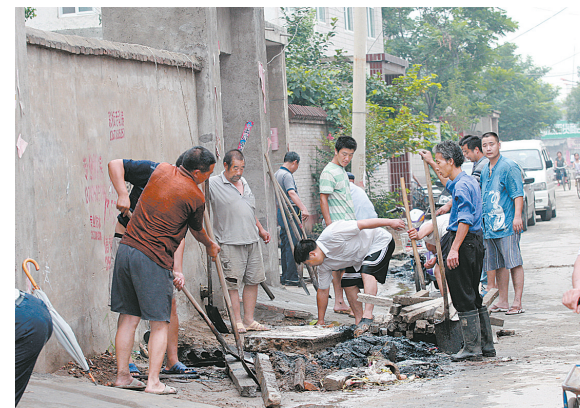
惠济区新城街道200多名党员在义务劳动中度过“七一”。他们把全村的下水道清理一遍,挖出污泥几大车。 本报记者 张立 通讯员 崔建松 摄
