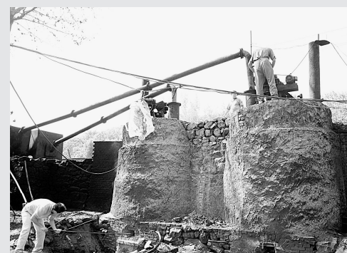
近日,登封市环保局三中队在下乡例行检查中发现一家正在生产的新建小炼油厂,经检查,该厂无任何环保手续及除污设施,属国家明令禁止的十五小企业。该厂中队现场拆除了该厂主要生产设施,并责令该厂7日内恢复地貌。 通讯员 牛朝峰 摄
