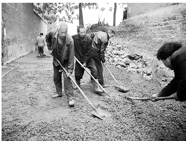
“俺村路修好后出门就方便多了!”11月9日上午,中岳办事处宋村村民看着家门口将要修好的水泥路,脸上露出了笑容。据了解,中岳办事处针对宋村村民出行难的问题,投资30多万元为该村修建1700多米的水泥路方便村民出行。 记者 许大桥 通讯员 王晓慧 摄
