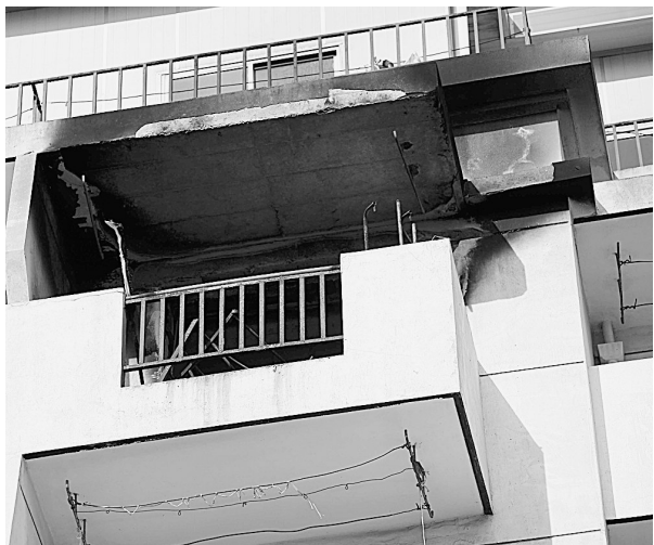
11月14日,发生火灾的602宿舍阳台被大火熏黑。
