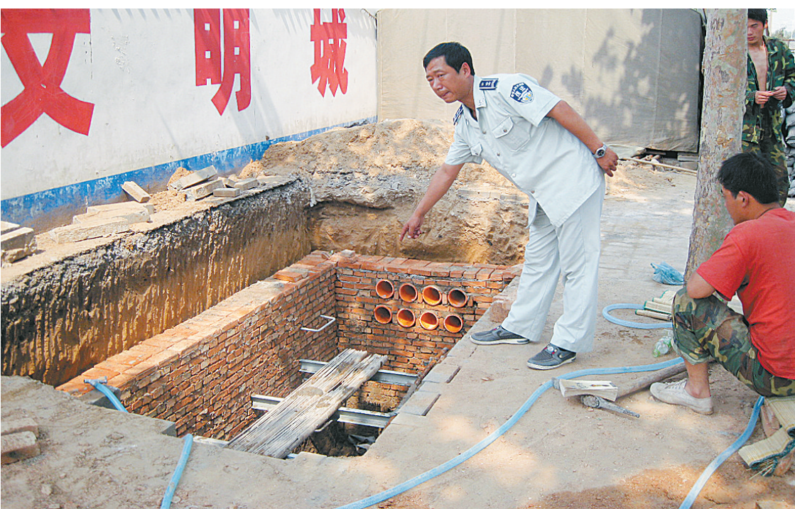
昨日,记者在长江路和京广路交叉口附近看到,长江路上被挖了3个大深坑,长6米、宽2.7米、深3.2米,四周没有任何警示标志。二七区执法局要求施工方出示占道许可证无果后,责令其停止施工,并在四周设置了围挡,提醒市民出行注意安全。 本报记者 安群英 摄
