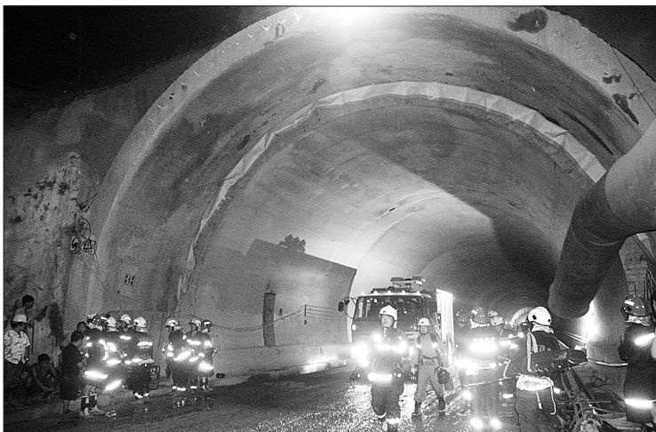
塌方事故救援现场(6月5日摄) 新华社发
