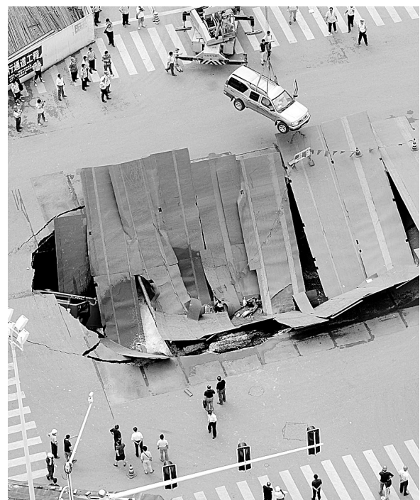
8月8日13时20分左右,正在施工中的合肥市长江路四牌楼地下人行通道南北向主通道发生塌陷事故。事故未造成人员伤亡。新华社发
