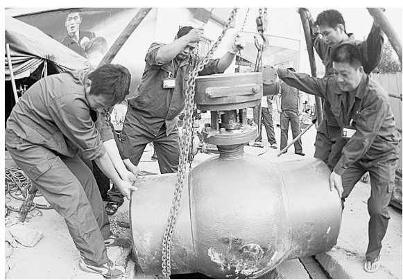
昨日,市热力总公司北区分公司职工,开始对辖区80多个支线进行阀门更换和网站维修,确保今年冬季暖气管网安全运转。 本报记者 汪静文 摄
