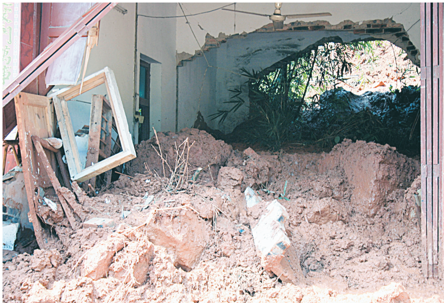
8月30日拍摄的被泥石流冲毁的房屋。 新华社发
