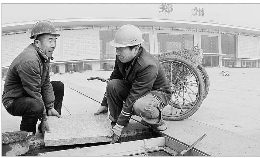
昨日,记者在郑州火车站西出口施工工地看到,工人们正在连轴施工,确保春节前西出口站的绿色通道投入使用。本报记者 汪静文 摄
