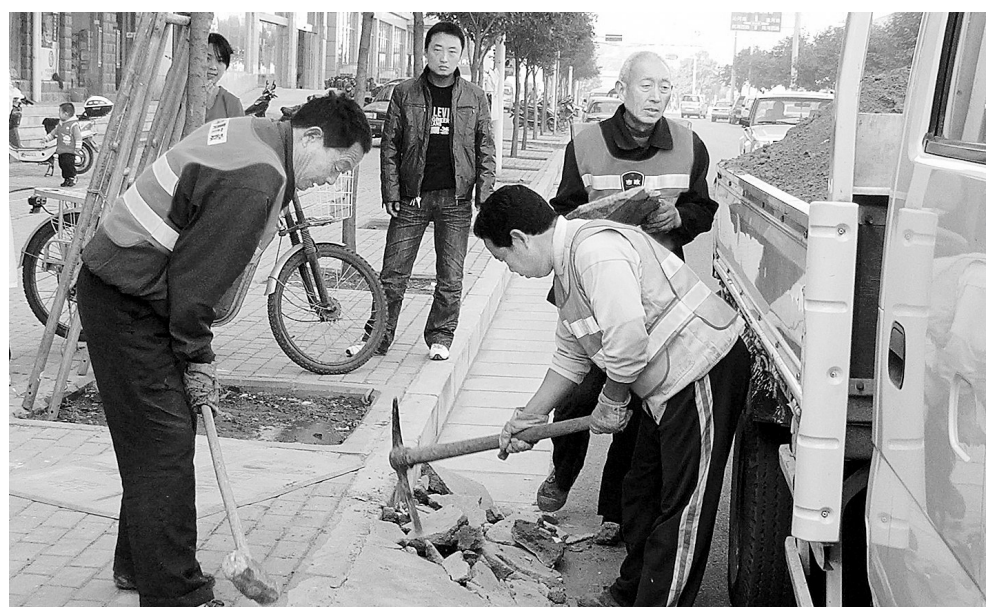
为保障市民雨雪天气安全出行,昨日,中原区市政所工作人员对区管道路的抹冰进行了巡查清理。 本报记者 宋晔 摄
