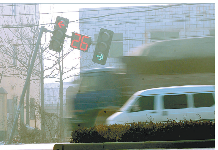
昨日,在南四环与大学路交叉口,一处倾斜着的信号灯仍在工作。灯下车辆行人来往不断。因信号灯电源未切断,一旦遇到下雨或下雪天气,极易出现漏电情况,希望有关部门及时处理。 本报记者 宋晔 摄
