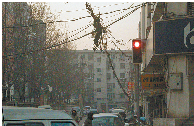
本报讯(记者 郑磊 通讯员 徐克 文/图)“我们这儿电线都成‘蜘蛛网’了,有几根几乎垂地,太危险了!”昨日上午,市民王先生拨打本报热线反映,政通路与交通路交叉口附近十几根电线,网线交织一团,悬在半空,这让过往市民心生担忧。
