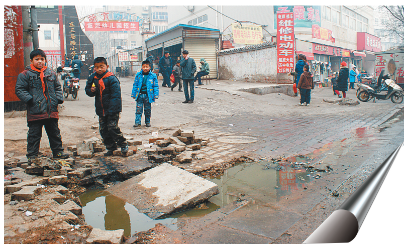
东三马路小学门前窨井盖冒水,一旦出现大幅降温,结冰路面将威胁小学生的人身安全。
