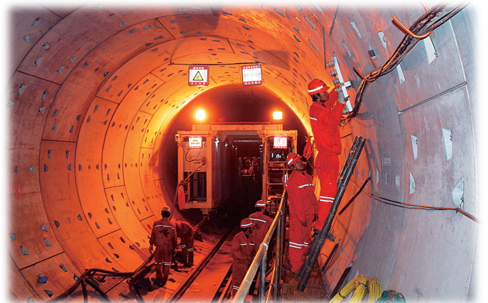
2009年11月16日,“郑州一号”盾构机的成功始发及顺利掘进标志着地铁建设进入到了一个新的阶段
