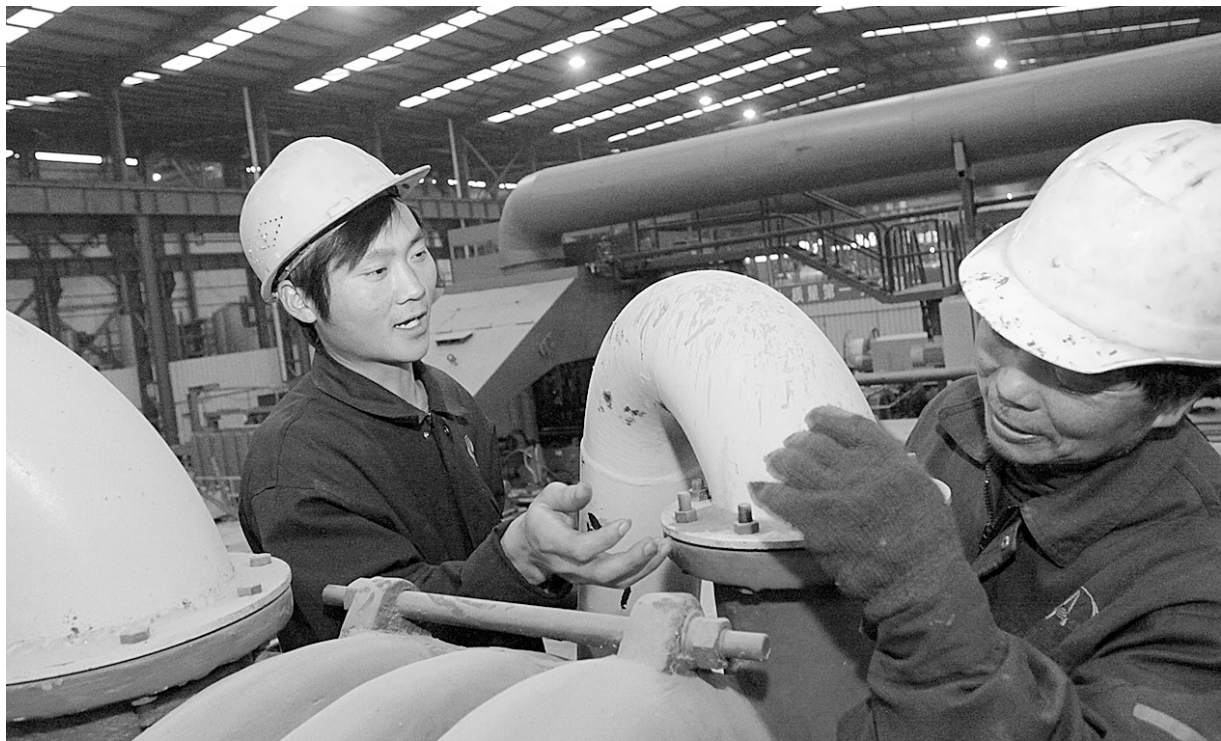
庚寅年黄帝故里拜祖大典成功举办后,借拜祖大典的福气,新郑各行各业紧紧抓住机遇,纷纷鼓起干劲投入生产建设中,全市上下一派火热的发展景象。昨日,记者在该市八千乡郑州市华驰薄板科技有限公司生产车间看到,工人们正忙碌着安装2号冷轧机组,以扩大生产规模,提升企业在市场上的竞争力。
