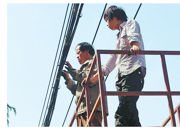
从昨日起,二七区开展围剿“蜘蛛网”、梳理“架空线”,集中对31条道路上的架空线缆进行归拢整治。此项整治工作预计今年7月下旬完成。昨日,施工人员对大学路、陇海路、兴华街进行整治。
