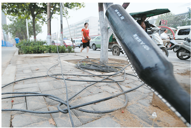
昨日,在航海路与大学路西南角,不少电缆裸露在慢车道和人行道上,很是危险,希望有关部门及时处理,以免出现不必要的损失。本报记者 宋晔 实习生 徐宗福 摄
