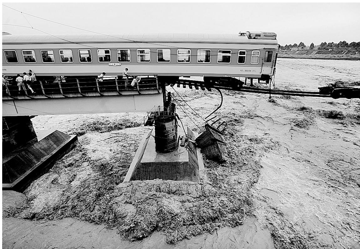
洪水冲垮宝成线一铁路桥事故现场。
