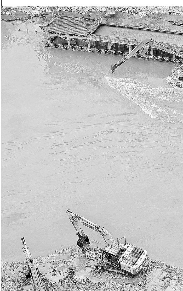
8月30日上午,在舟曲城江桥上游段凉亭附近,武警部队官兵加大对城关桥以下河段河道的挖掘力度。 新华社发
