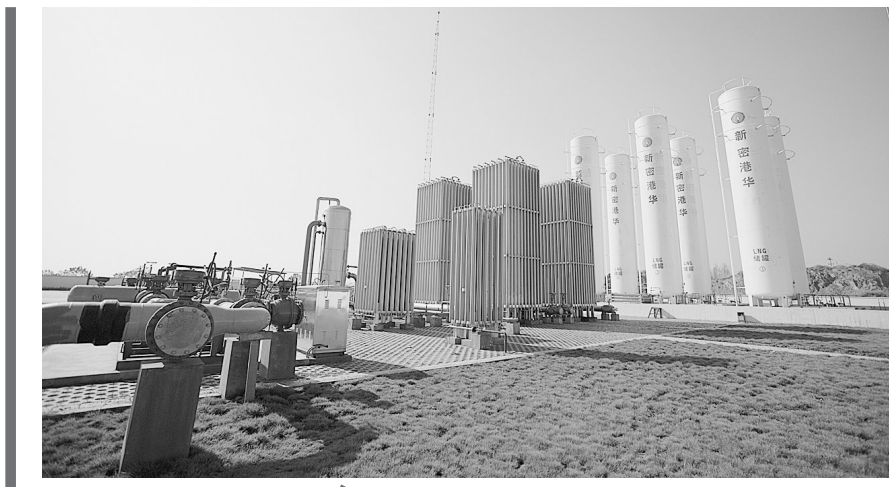
图为新建成的新密港华燃气有限公司燃气站。
