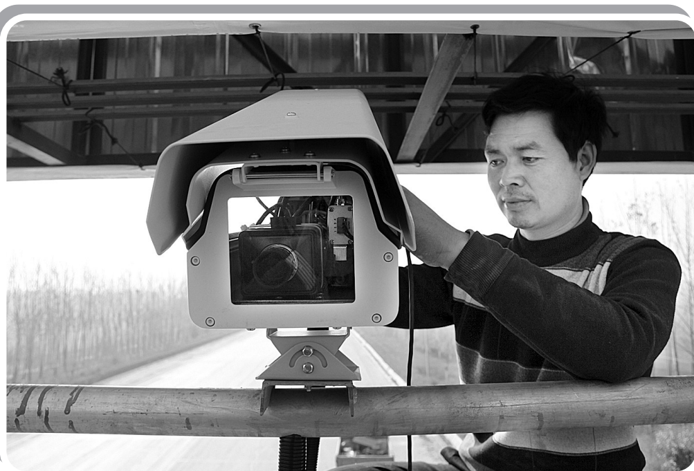
今年,新郑市在全市主要出入口、边界等处安装治安监控卡口,实施路面全程监控。目前,全市20处治安监控卡口设备安装、光纤铺设已全部到位,即将投入使用。图为技术人员正在对卡口设备进行调试。
