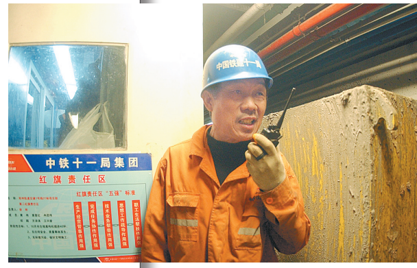
▲隧道施工的工作面长达1.3公里，下达指令通过对讲机来完成。
